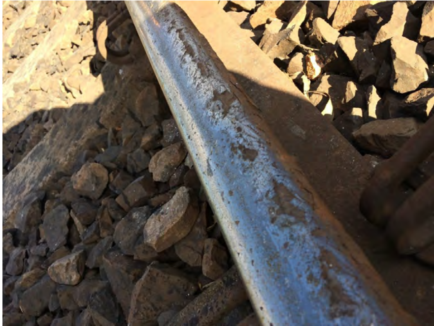
Figura 2 – Despedaçamento do canto de bitola na Via Permanente.
