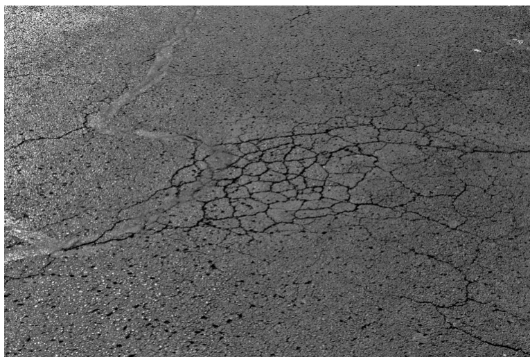
Figura 1 – Trincamento por fadiga em revestimento asfáltico [1].
